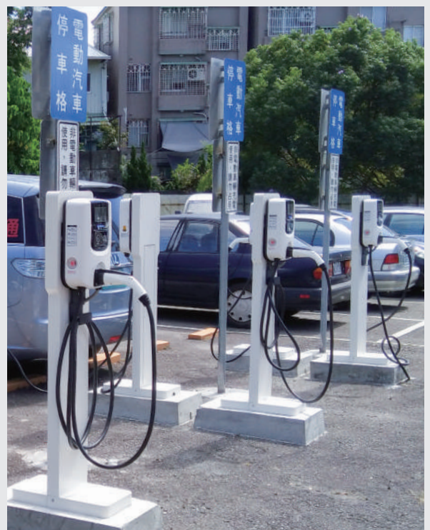
▲ 陽明大樓第二停車場電動汽車充電設備
