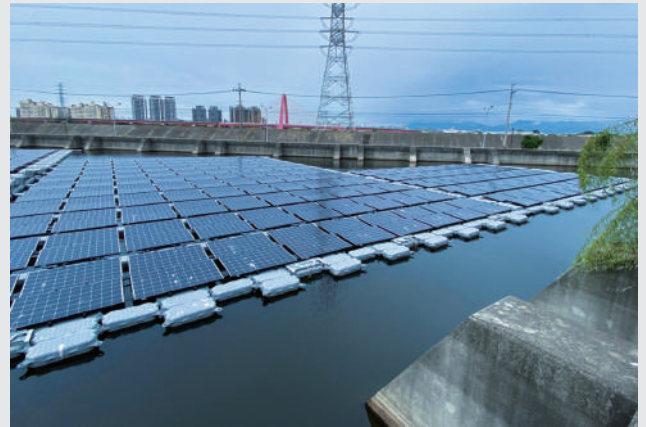
▲ 高鐵烏日滯洪池水面型太陽光電
